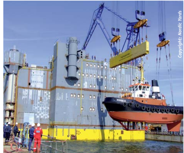
Das Bild zeigt die 800-Megawatt-HGÜ-Offshore-Plattform Bor-Win2 beim Ausschwimmen in der Werft von Nordic Yards in Warnemünde. Es ist die zweitgrößte von vier HGÜ-Konverterplattformen, die Siemens zum Anschluss von Windparks ans deutsche Stromnetz für den Netzbetreiber TenneT in der Nordsee installieren wird.
